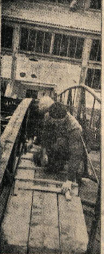
Kotlarna in obrat vezanih plošč sta spojena s mostom. Po njem bo tekel transporter, ki bo iz obrata prenašal v kotlarno lesne odpadke. Uporabljali jih bodo za kurjenje kotla. S pomočjo tega transporterja bodo prenašali tudi premog od industrijskega tira do kotlarne. Delavci so most, namenjen za transporter, med gradnjo pokrili s deskami in ga uporabljali kot most v pravem pomenu besede, da so si skrajšali pot in izognili blatu.
