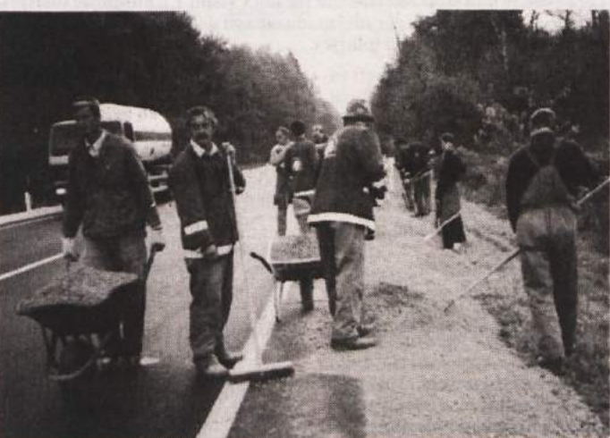
DELO NA CESTI - Na magistralni cesti Jesenice-Obrežje pri odcepu za Krško se konča več kilometrov dolg odsek, na katerem je Cestno podjetje Novo mesto položilo v preteklem obdobju nov asfalt. Tam, kjer so asfaltirali nazadnje, so delavci pred dnevi nasipavali in utrjevali bankine. Pred delom na cesti so postavili več prometnih znakov, s čimer so hoteli opozoriti nase in si zagotoviti kolikor toliko varno delo. Vsem znakom navkljub je glavčina vozil z nezmanjšano hitrostjo drvela mimo skupine delavcev. Na sliki: delavci nasipavajo rob ceste. (Foto: L. M.)
