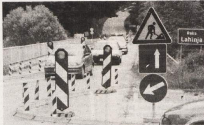
POLOVIČNA ZAPORA - Zadnjih deset mesecev, kar poteka promet po mostu na Primostku le po enem voznom pasu, se je cestišče precej poškodovalo, prav tako pa tudi signalizacija.
