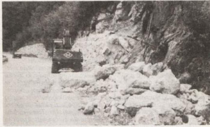
SKALOMET IN BETONSKI SLOPI V ZAŠČITO REGIONALKE - Delavci novomeškega cestnega podjetja si že nekaj časa prizadevajo, da bi regionalno cesto R-326 Boštanj - Mokronog, zlasti na odseku do Jelovca, kjer je regionalna vpeta med reko Mirno in okoliškimi hribi, uredili, da bi po njej potekal čim bolj varen promet. Z brežin na cesto namreč pogosto pada kamenje in celo skale, zato je pozornost voznikov na tej ovinkasti cesti, zlasti ponoči, ni nikoli odveč. Cestariji zdaj urejajo 90 m skalomet pod Pingartom, pred Račovanom pa so v podporo brežine namestili v dolžini 22 m armiranobetonske slope, ki jih bodo te dni prišli sidrat v brežino delavci Geološkega zavoda iz Ljubljane. Promet bo tako še nekaj časa potekal izmenično, na zoženem cestišču pa ga urejajo tudi s pomočjo semaforjev. (Foto: P. P.)
