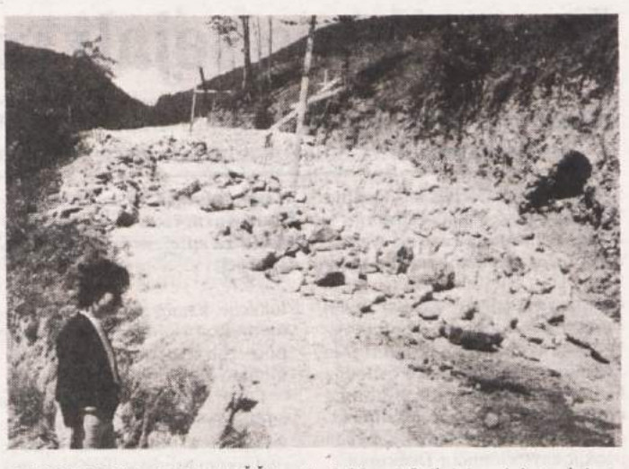
DOSTOP DO POKOPALIŠČA - Na Selih pri Osilnici urejajo te dni cesto do pokopališa in podporni zid (na fotografiji), medtem ko so ograjo okoli pokopališča dokončali pred kratkim. Dela opravlja občinska komunalna skupina. Prihodnje leto bo prišla na vrsto tudi gradnja mrliške vežice. (Foto: J. Primc)
