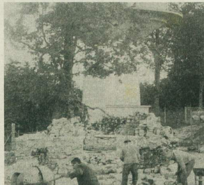
GRADBIŠČE NA TRDINOVEM VRHU - Pod vodstvom župnijskega urada Šentjerej in strokovnim vodstvom Zavoda za varstvo naravne in kulturne dediščine hitijo delavci obnovljati ostanke cerkvice sv. Jere na Trdinovem vrhu. Gre za obnovo, utrditve in zavarovanje židov, ki bodo posledje obiskovalcem najvišjega vrha Gorjanec ponazarjali nekdanji sakralni objekt. Glavna dela bodo opravili do 18. julija, ko bo pri obnovljenih ostankih sosednje cerkvice sv. Ilije maša, ki se je bodo udeležili predvsem prebivalci sosednje Hrvaške, napovedujejo pa tudi obisk kardinala dr. Kuharica. Nacional-socialna zveza Slovenije pa pripravlja ta dan ob 11. uri na Trdinovem vrhu zborovanje, na katerem nameravajo poudariti, da je najvišji vrh Gorjanec slovenski. (Foto: M. Vesel)
