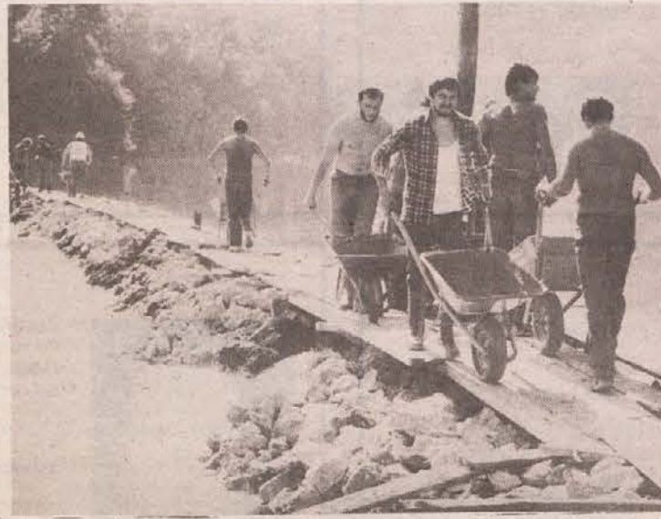
RIBIČI REŠUJEJO JEZOVE — Stari jez na Krki v Lešnici je bil ves minuli teden v znamenju velike delovne akcije članov ribiške družine iz Novega mesta. Ob finančni podpori Vodnogospodarskega podjetja se je obnove 150 metrov dolgega jezova lotilo več kot 500 ribičev. Napeljali so prek 60 m 3 kamna in utrdili jez z 60 m 3 betona. Podoba jezova je sedaj precej drugačna. Z novo pregrado se bo nivo Krke dvignil skoraj za 30 cm., kar bo še najbolj koristilo ribam in vodni flori. Ribiška zagnanost je na tak način od sedaj rešila že pet jezov, za naslednje leto pa imajo v načrtu še jez v Novem mestu, Srebrničah in Otočcu. (Foto: J. Pavlin)
