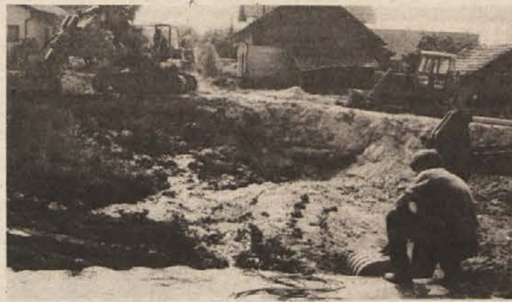
PREUSMERILI BODO TOK VODE — Tu bo po posebnem kanalizacijskem sistemu okoli 10 m pod površjem tekla preusmerjena voda Bistrice v potok Sajevec in akumulacijo pri Prigorici. Zaradi teh del je bilo treba razdreti tudi precejšen del asfaltirane ceste proti Sajevcu (na fotografiji). (Foto: J. Prime)
