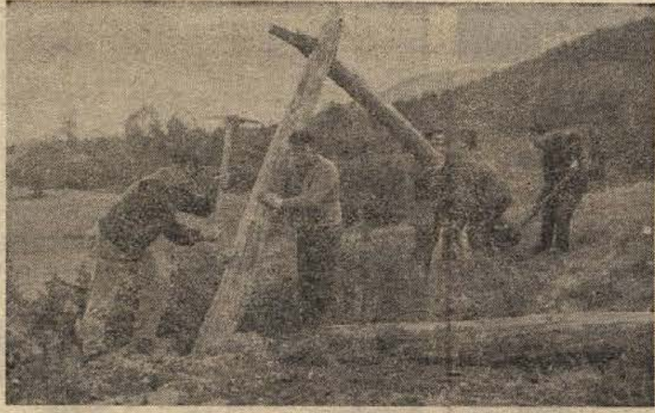
Dotrajale lesene »koze« smučarske žičnice v Crmošnjicah bo te dni zamenjala železna konstrukcija, urejena pa bo tudi zgornja postaja žičnice. Na sliki: najstarejši med sobotnimi in nedeljskim prstovoljci je tov. Grobovšek, razen njega v prostem času pri vseh delih stalno »dežurata« še Andrej Peric in Marjan Sonec, pomagajo pa tudi drugi člani upravnega odbora društva »ROG« (Foto: T. Gošnik)
