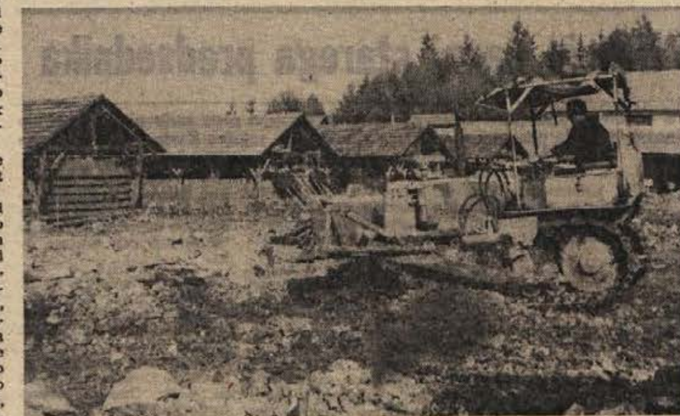
V klenžarski opekarni so začeli graditi nove proizvodne prostore. Za sušilnicami opeke riže buldožer, delavci pa že kopljejo temelje. (Foto: Ria Bačar)
