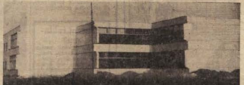
Zadovoljstvu občanov se bo ob otvoritvi nove šole v Brežicah pridružila prijetna zavest, da je vsak prispeval zanjo svoj delež. Na sliki: pogled na del šole med gradnjo. (Foto: J. Teppey)
