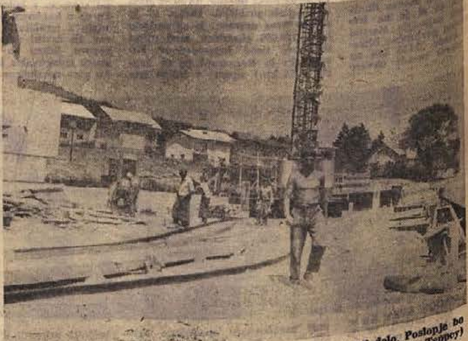
Na gradbišču osnovne šole v Krškem je Pionir dobro zastavil delo. Poslople do do zime pod streho, vseljivo pa prihodnje leto. (Foto: Jožica Tepper)
