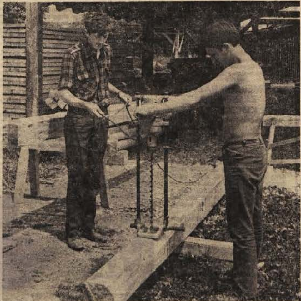
Vajenca, ki obiskujeta poklicno šolo za tesarje, se učita ravnanja z električnim vrtilnim strojem.
