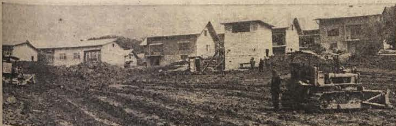
Minuli teden so se začela pripravljala dela za gradnjo nove osnovne šole v Krškem. Po štirje buldožerji ravnaajo zemljišče in pripravljajo cesto do gradbišča. (Foto: Jožica Teppey)
